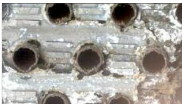
FIG. 1 Corrosione di coil Cu-Al. Cu-Al coil corrosion.
